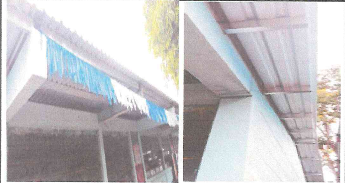
Foto 2: Los trabajadores empiezan a sustituir la lamina de las aulas por laminas troqueladas
